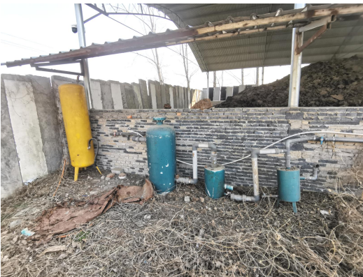
沼气脱水脱硫装置
