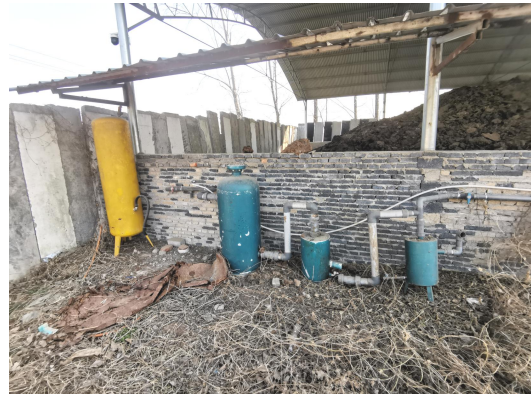
沼气脱水脱硫装置未利用
