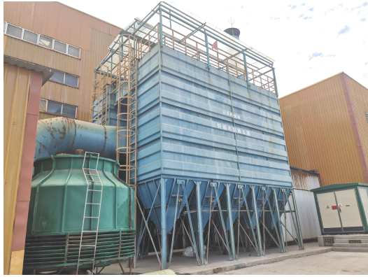
已建锌烟除尘设备及排气筒
