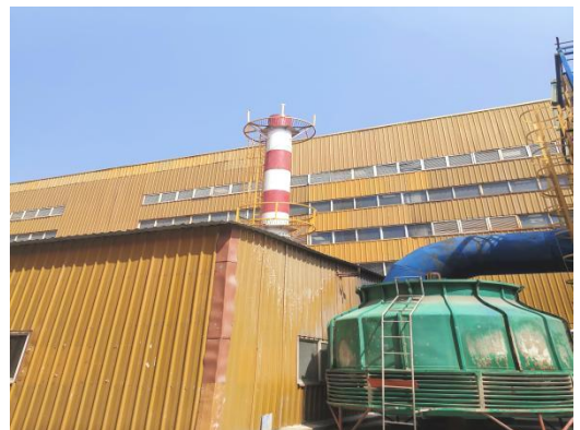
已建天然气加热炉排气筒
