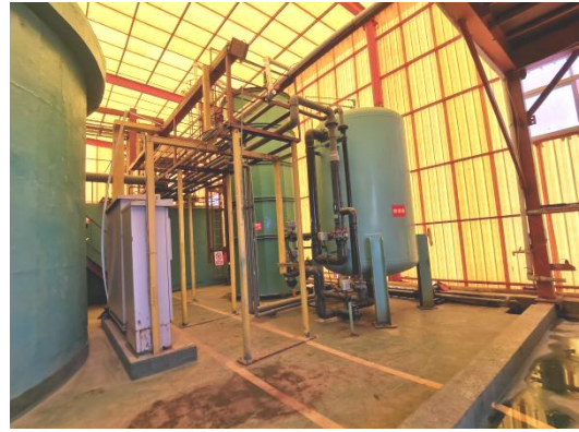
已建 360m 3 /d 污水处理站
